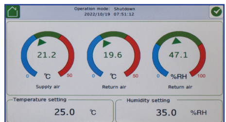
Upravljački ekran rashladne inrow jedinice
